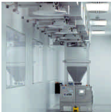
Automatisches Einwaagesystem Großkomponenten
