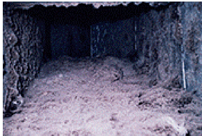
Kanal in Benutzung (es kann passieren, dass der Schimmel den Kanal fast ganz verstopft)
