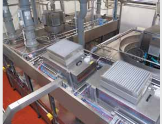
Zuluft- und Abluftsystem an einer Aseptik-Abfüllmaschine
